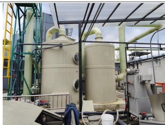
生物滤池+水洗喷淋
